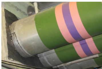
保温管道穿墙防火封堵 (FS-L 防火硅酮泡沫)
