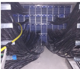
电缆沟阻火墙 3 (HL-MCT 封堵系统)
