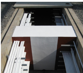
电缆沟阻火墙 1 (FC-1 防火灰泥系统)
