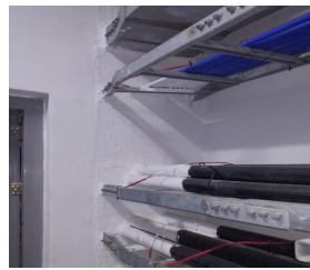
电缆隧道阻火墙 (FB-1 防火涂层板系统)
