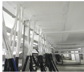
盘柜底部电缆夹层孔洞防火封堵 1 (FB-1 防火涂层板系统)
